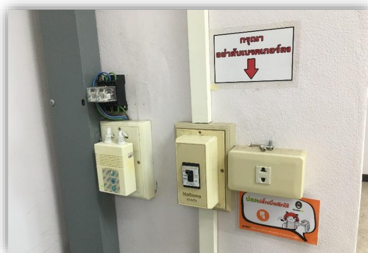
ภาพที่ 275 เบรกเกอร์ไฟฟ้าหลักในสถานะเปิดใช้งาน
