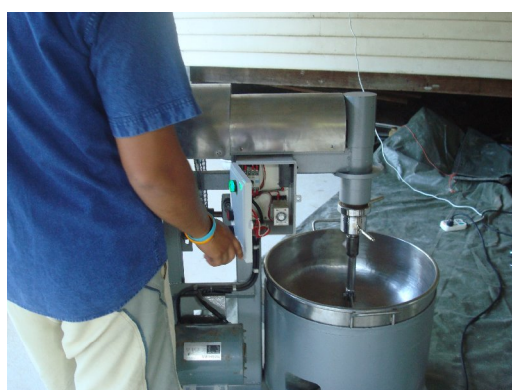
การติดตั้งรีเลย์ควบคุมเวลา ที่มา (ดร.ณิ ภู่ง, 2553)
